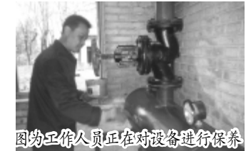
图为工作人员正在对设备进行保养
